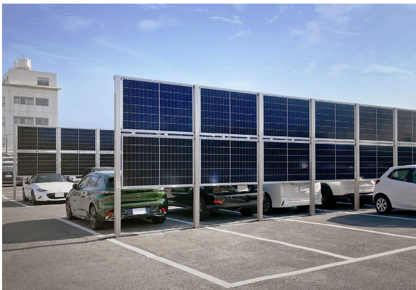
駐車場への設置例
